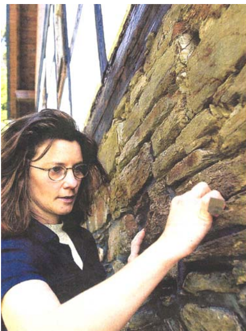
Bei der Arbeit lernt sich der Mensch am ehesten kennen und auszudrücken: Yvonne Buschmann, die Steinmetzin, verfügt die uralten Natursteinmauern an der Westseite des Wohnhauses.
